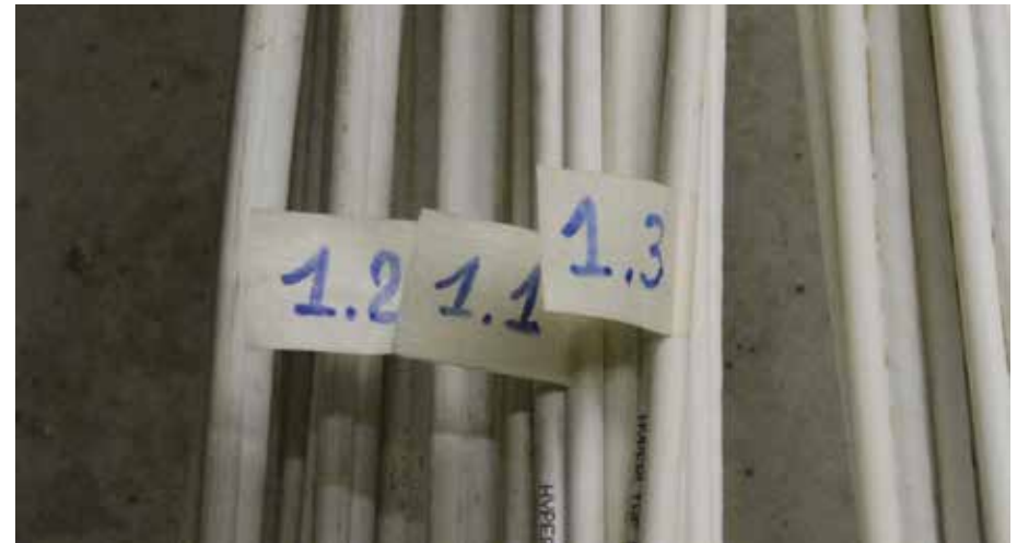
Labeling van de kabels
