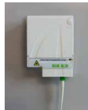
Point de raccordement du fibre optique
