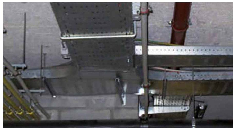
Chemins de câbles
