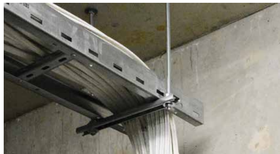
Échelles de câbles
