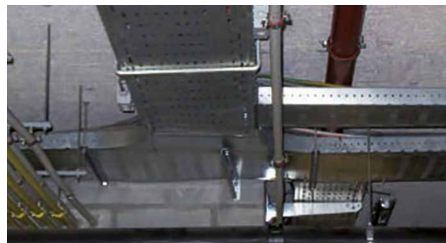
Chemins de câbles
