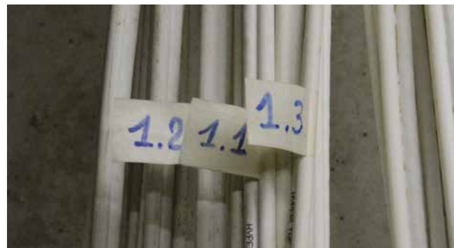
Identification des câbles
