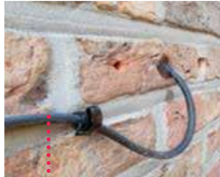
bestaande Proximus fiber-aansluiting op de gevel
